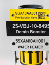
Značení potrubí str. 40
